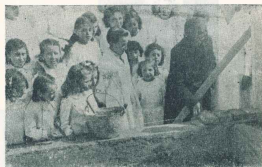
Doña María M. de Clemente, una de las más antiguas vecinas de la localidad, coloca los primeros ladrillos sobre los cimientos del edificio.
