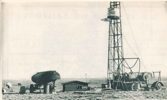
Torre de perforación que hace operar el Consejo Agrario de Santa Cruz para disponer de agua en distintos sectores de la Provincia.
